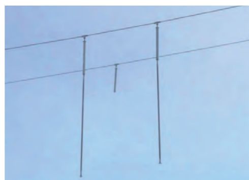
Рис. 2. Разрушения распорок на ВЛ 110 кВ.
